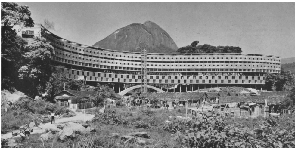
Abb. 14: Marquês de São Vicente, Ansicht von Norden auf den Rohbau mit der Barackensiedlung im Vordergrund (Giedion/Franck 1960, S. 123).
